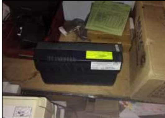
Satu (1) UPS - Lokasi: KK Jinjang
